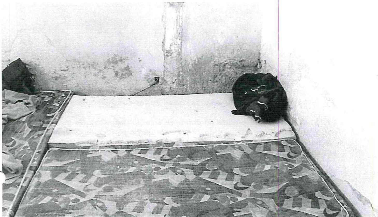
(13.1.) No existen camas suficientes; se observan múltiples colchones colocados en el piso.
