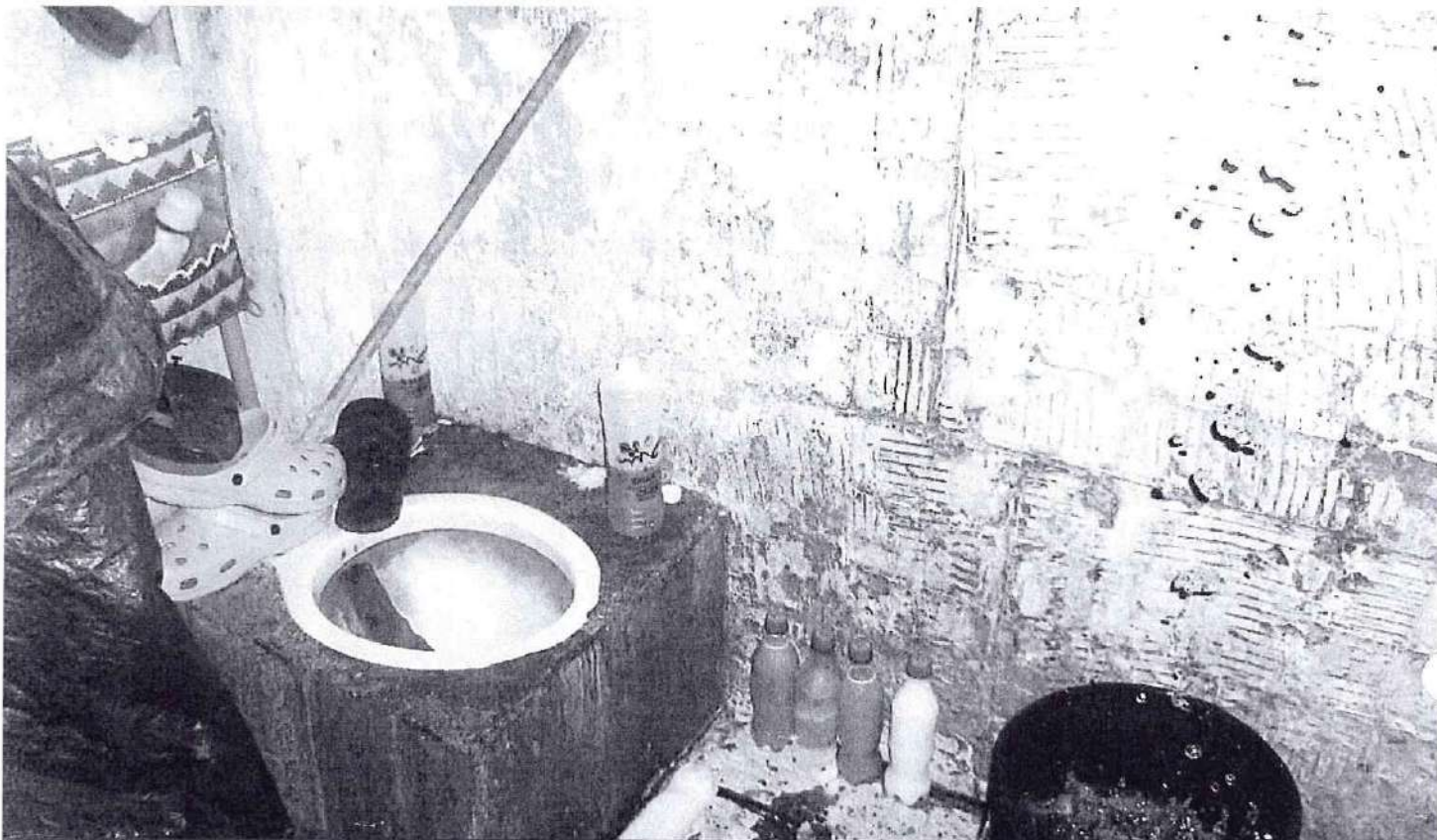
(14.1.) La población interna refiere frecuentes cortes en el suministro de agua lo que imposibilita la sanidad en las necesidades fisiológicas y la higiene personal.
